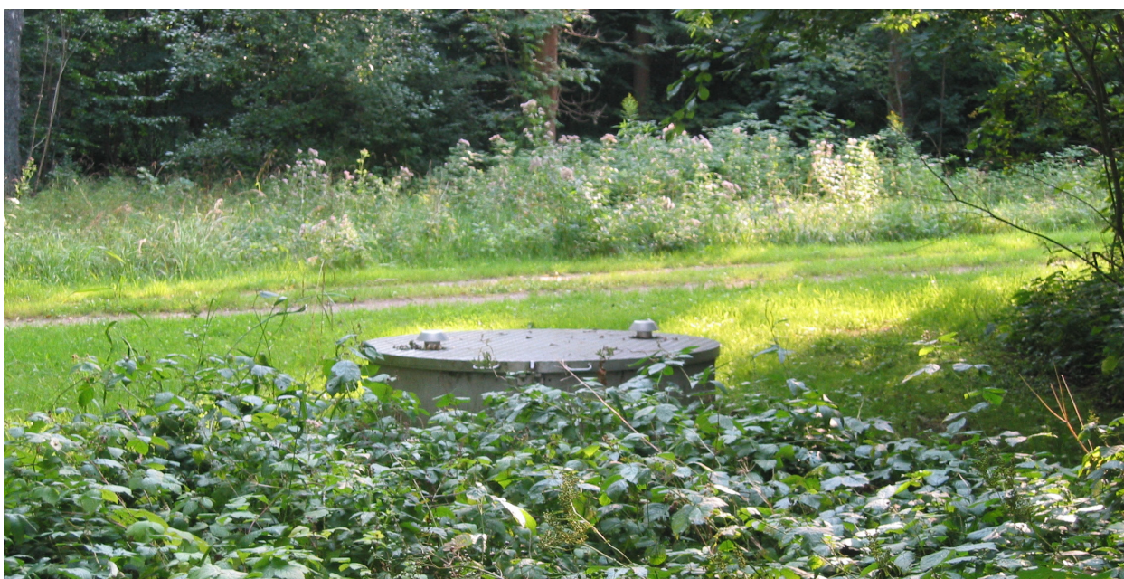
Man skal have tilladelse til at indvinde grundvand.
