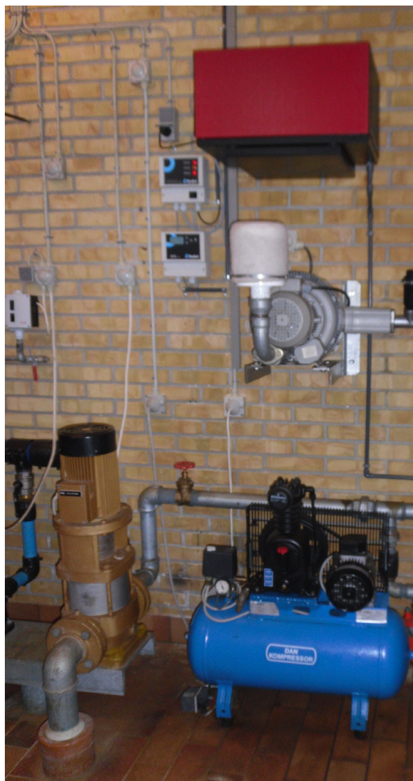
Tekniske anlæg på vandværk.
