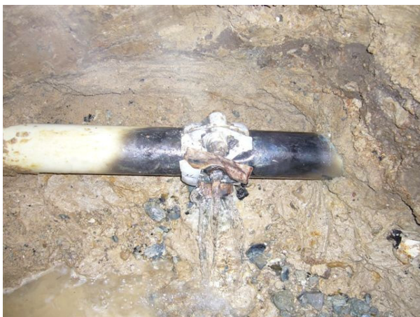
Brud på vandledning.
