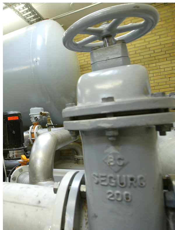
Tekniske anlæg på vandværk.
