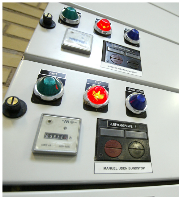
Styringstavle på vandværk.
